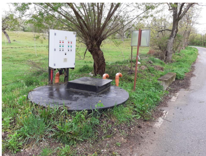
Statie pompare sat Rau Alb - canalizare
